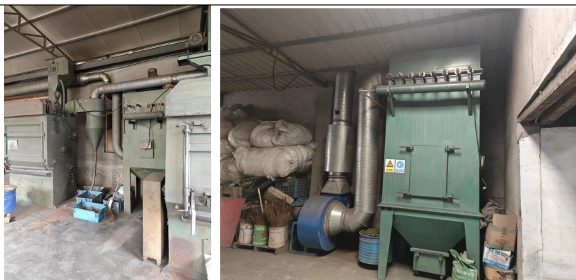
抛丸粉尘废气处理设施
