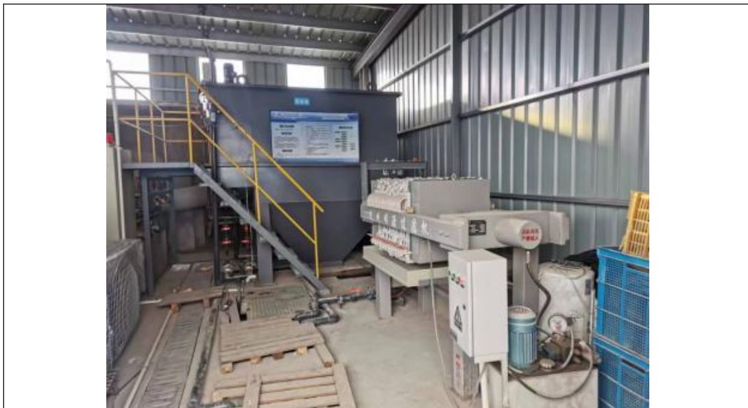
图3-2 废水处理设施
