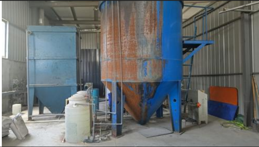
图3-2 废水处理设施
