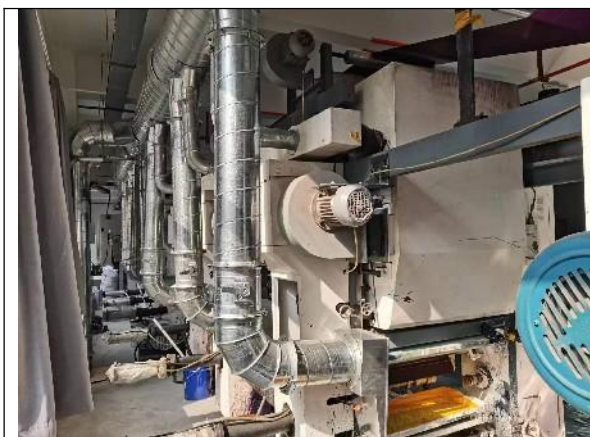
印刷线废气收集管线
