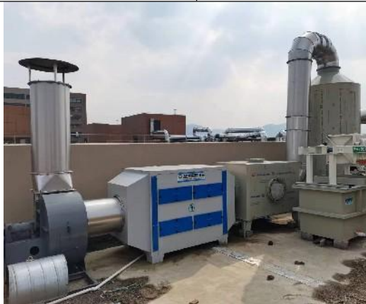
废气处理设施
