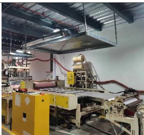
拉膜线废气收集设施
